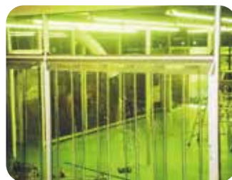
クリーンルーム
