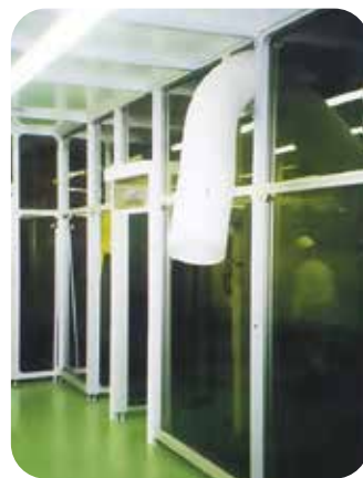
クリーンルーム
